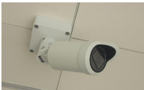
正面玄関前の防犯カメラ
